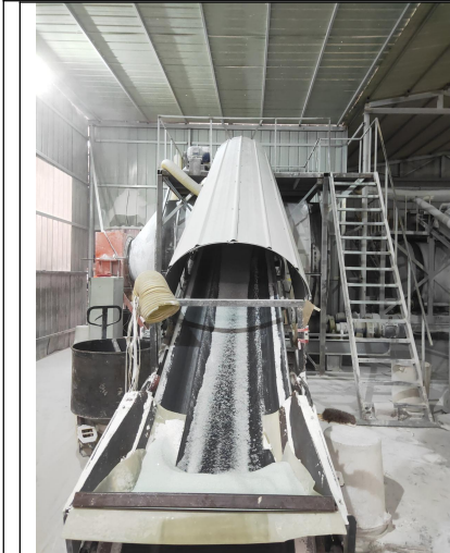
预混合粉尘集气管道和防尘罩
