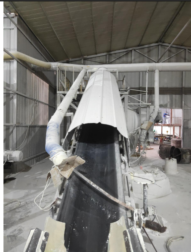
预混合粉尘集气管道和防尘罩
