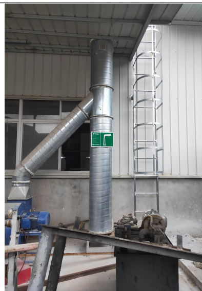
预混料粉尘、1#-4#生产线搅拌废气排气筒标识牌
