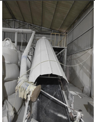
预混合粉尘集气管道和防尘罩
