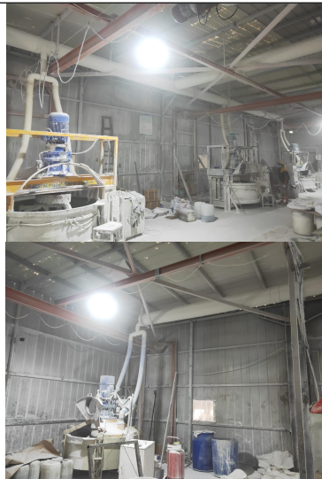
1#-4#生产线搅拌废气收集管道
