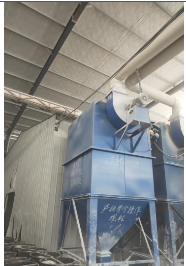
1#-4#生产线搅拌废气布袋除尘器
