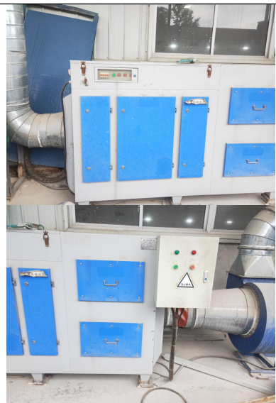
1#-4#生产线搅拌废气 UV 光氧活性炭一体机
