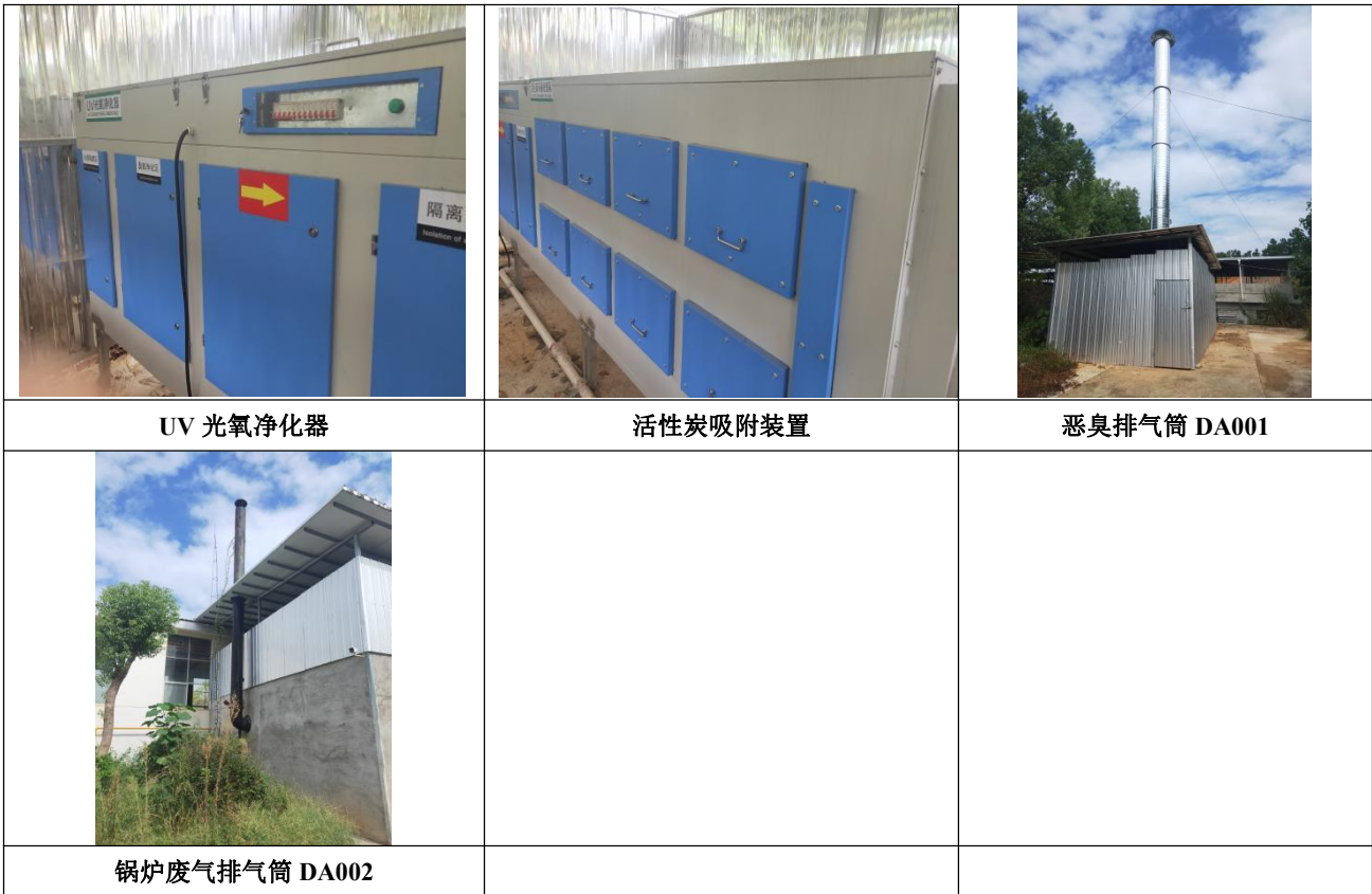
图 4-1-4 项目废气处理设施图片
