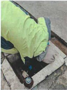
污水处理站进口
