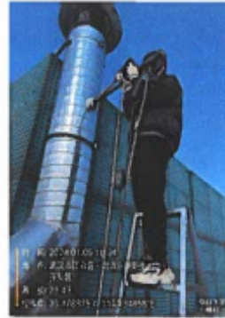
③ DA002 有机废气排气筒 (出口)
