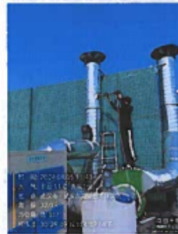
○1 DA001 酸洗废气排气筒
